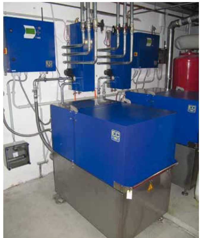
BHKW von EC POWER im Betrieb
