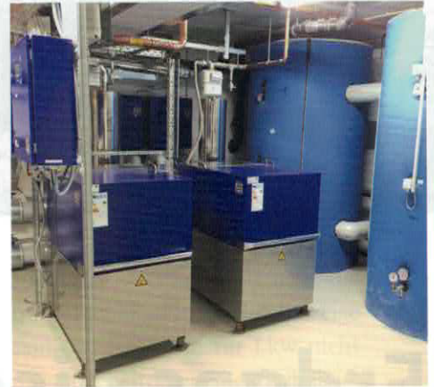
Die Erdgas-BHKW im Wohnpark Straßacker reduzieren Energiekosten und schonen die Umwelt.
