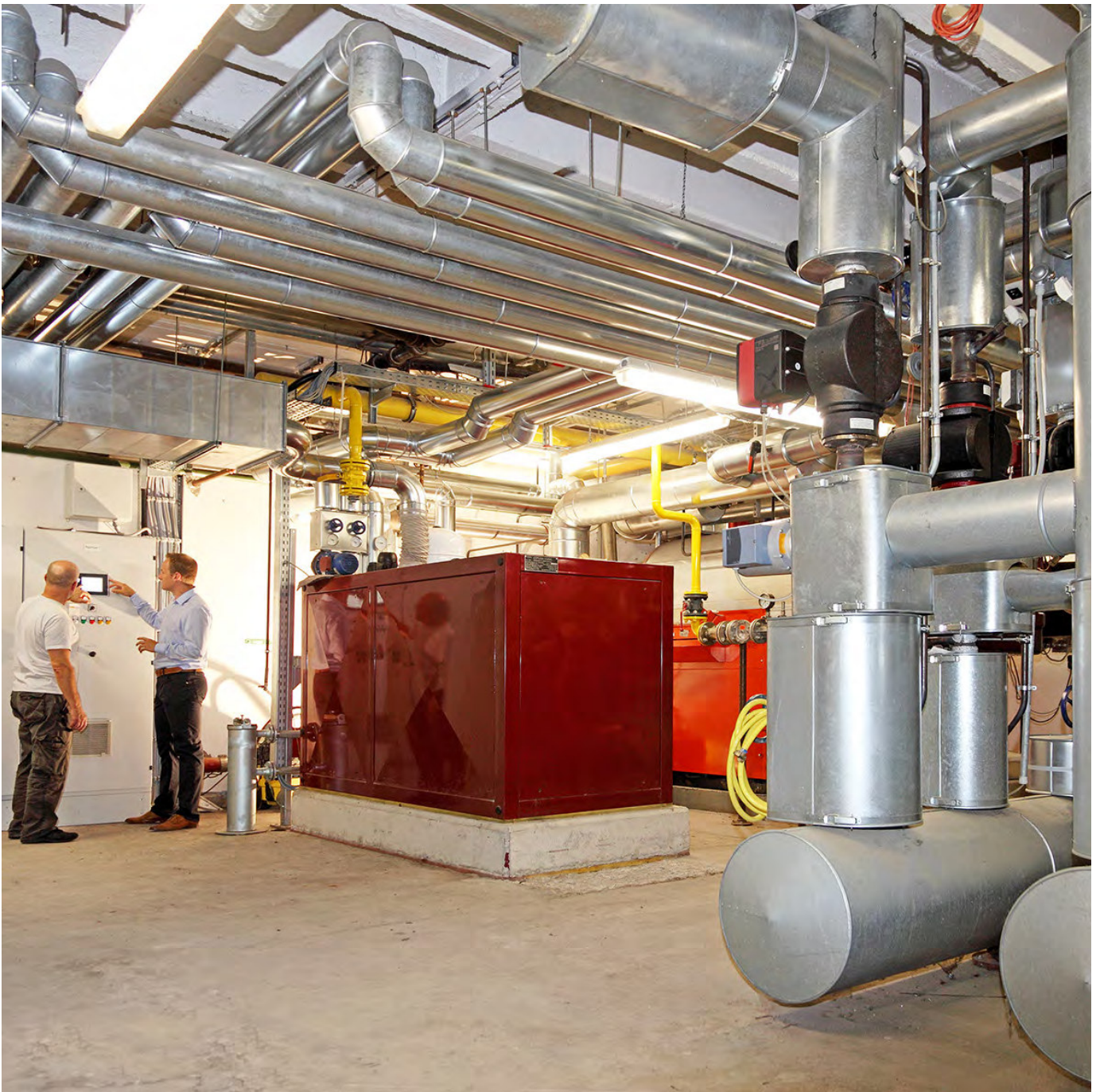
Abb. 5: Heizungsverteilung in einem versorgten Objekt
